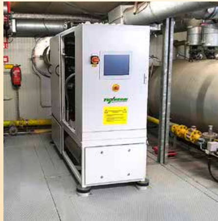
Das Blockheizkraftwerk ist auf dem Gelände der ehemaligen Bundeswehrkaserne am Mühlenbecker Weg stationiert.
